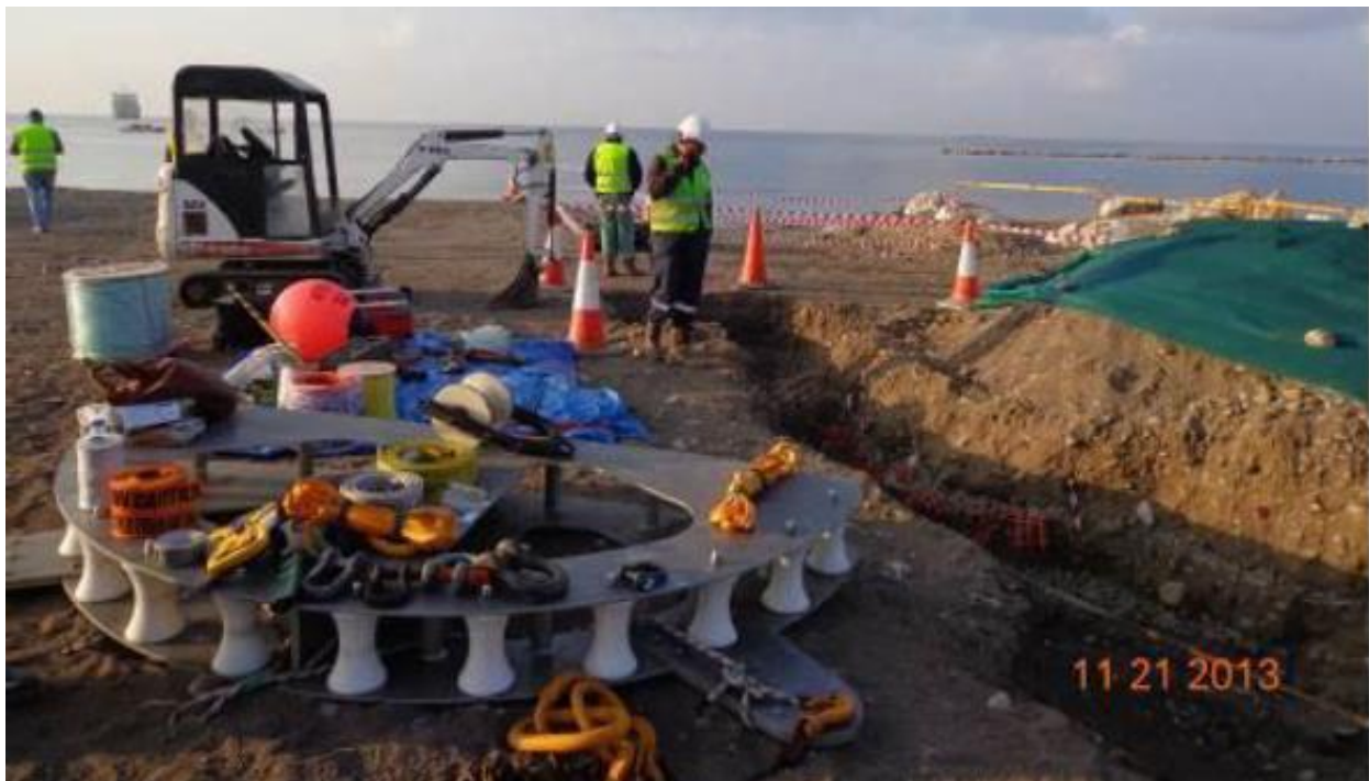
Figure 26 : Vue d'un quadrant (Source : Orange Marine)
