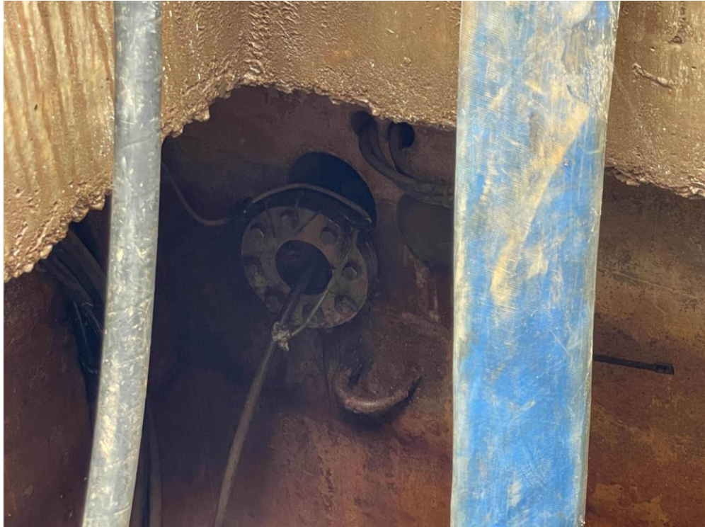
Figure 6 : Vue de l'intérieur de la chambre d'atterrage du câble AMERICAS-2
