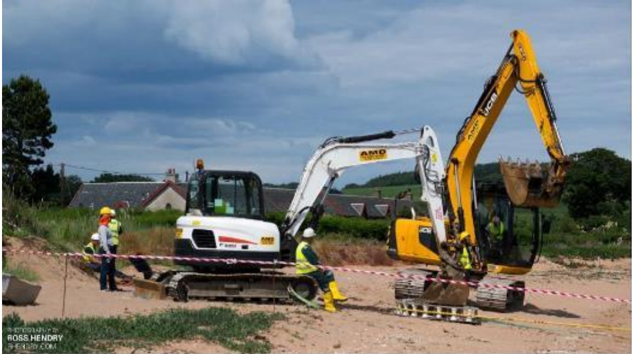
Figure 25 : Opération de tirage de câble avec deux pelleteuses et un quadrant (Source : Orange Marine)
